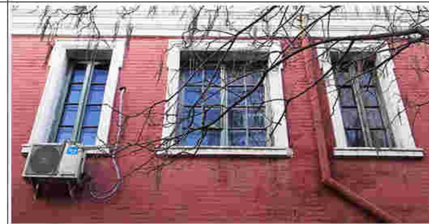
10. 北立面二层中间窗洞口
